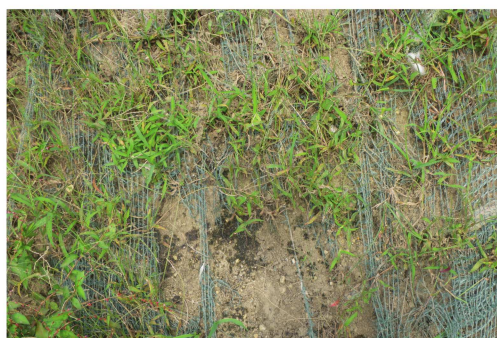
シカの食害により法面が崩れた状況
