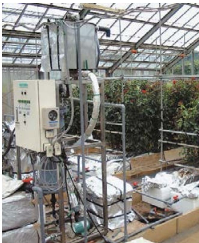
水処理システム
